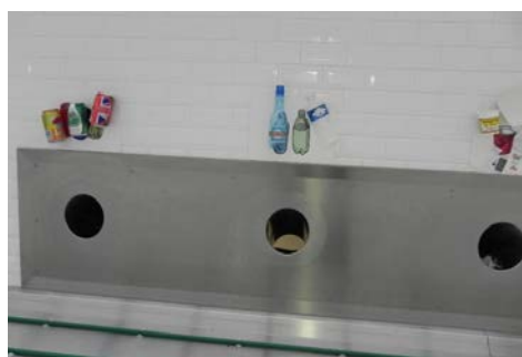
Derrière ce mur, des goulottes maintiennent les différents sacs de tri (métal, PET 11 , DIB 12 )
